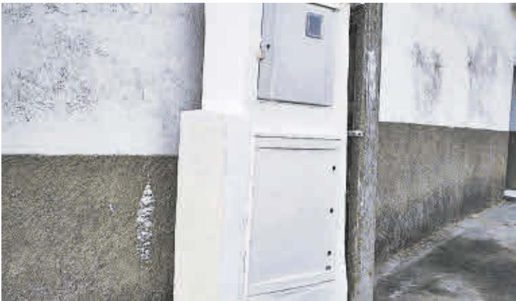
Nuevo cuadro eléctrico ya en uso.
