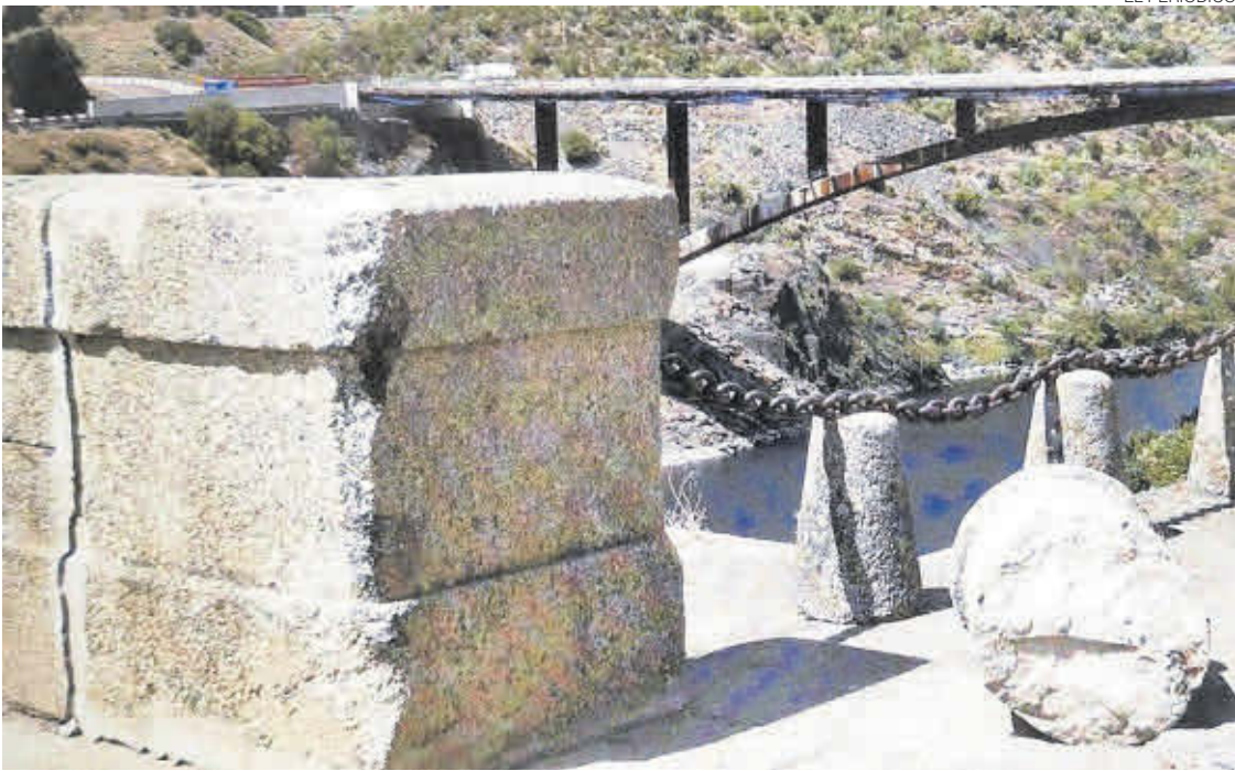
Daños provocados en una de las defensas del Puente Romano de Alcántara.
