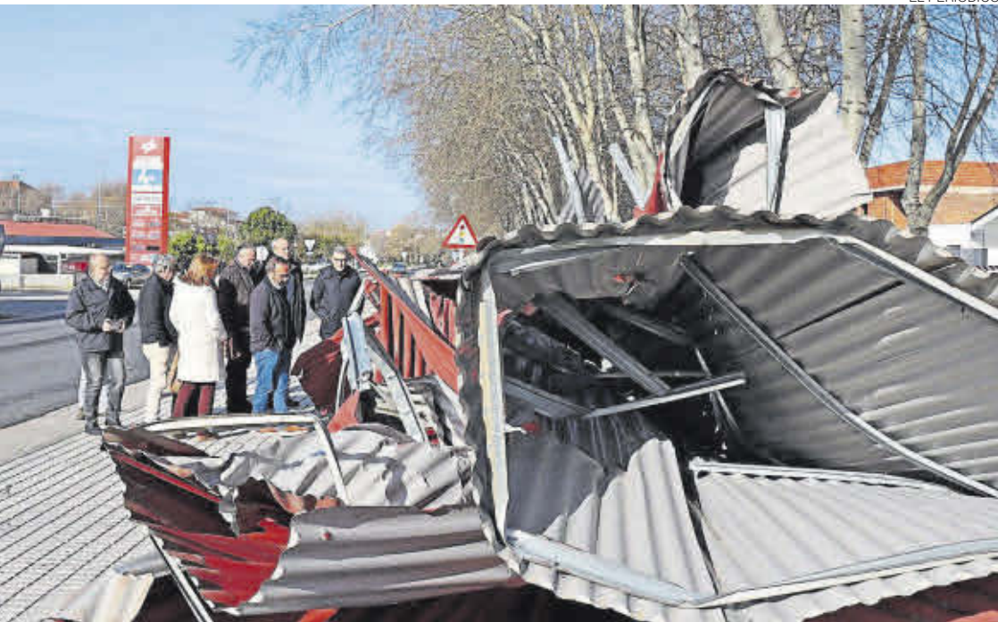
Materiales de la cubierta del Pabellón Municipal que voló hasta la gasolinera.
